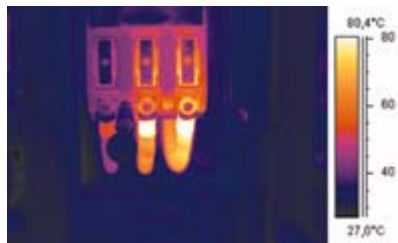
Corrosión e conexiones
